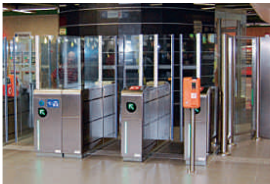
CONTRÔLE D'ACCÈS – MÉTRO DE BRUXELLES
